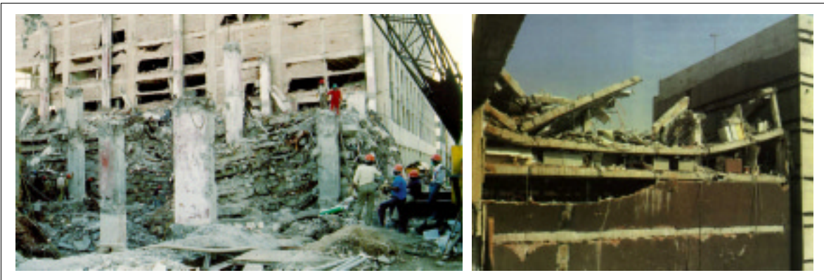
Abbildung 4: Schichtung von Flachdecken: Mexico City, Erdbeben 1985, [Tiedemann, Seite 416, 1992 und Münchener Rück, Seite 52,1986]
