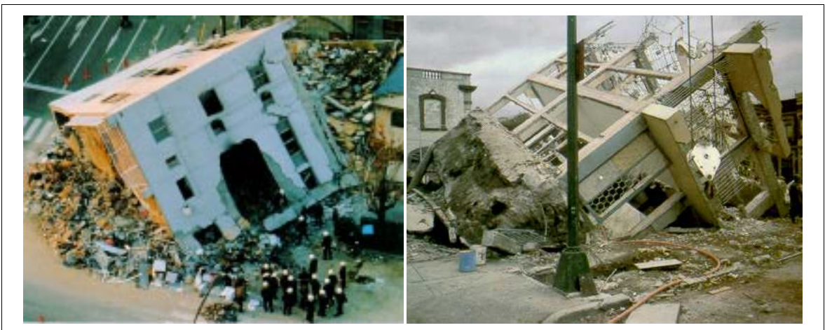
Abbildung 8: Gebäudeumsturz: Kobe, Japan, Erdbeben 1995 [Schweizer Rück, Seite 21, 1995], und Mexiko, Erdbeben 1985 [Münchener Rück, Seite 55, 1986]
